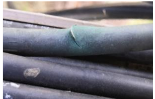
3. ábra: tönkrement szigetelés
