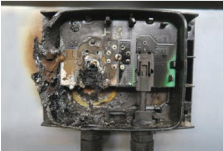
2. ábra: korrodált érintkezők miatt bekövetkezett csatlakozódoboz égés
